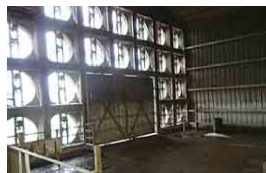
トンネル換気式牛舎の排出口
