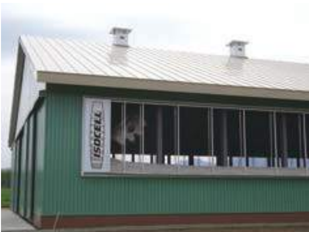
自動換気システムのエアカーテン。自動でカーテンが上下する
