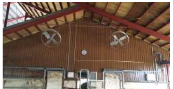
図11 | 待機場のミスト設置状況
